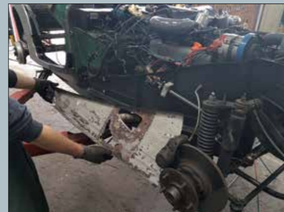
Wo der Rost zu sehr gewütet hatte, stellten die Restauratoren neue Bleche her.
